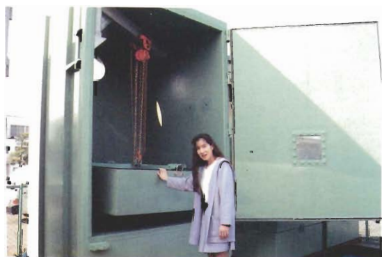
活性炭吸着塔 (回転取出し式)
